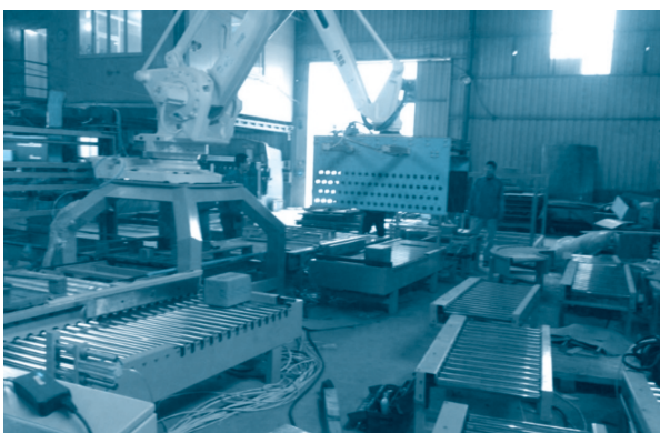
图1 码垛线装备实物图
