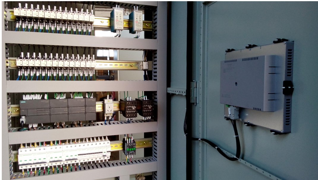
图 13 S7-200 SMART PLC 和 SMART 1000IE 触摸屏在控制柜照片
