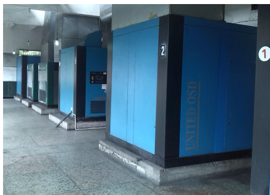
图 2 煤矿空压机房空压机放置情况
