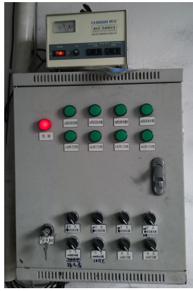
图 3 S7-200 SMART PLC 控制的自动放水装置的控制柜
