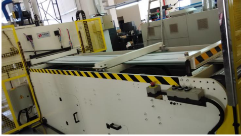
收料和堆垛部分
